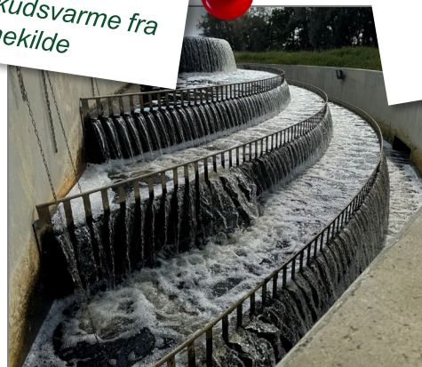
1 varmepumpeanlæg med rensset spildevand som varmekilde
