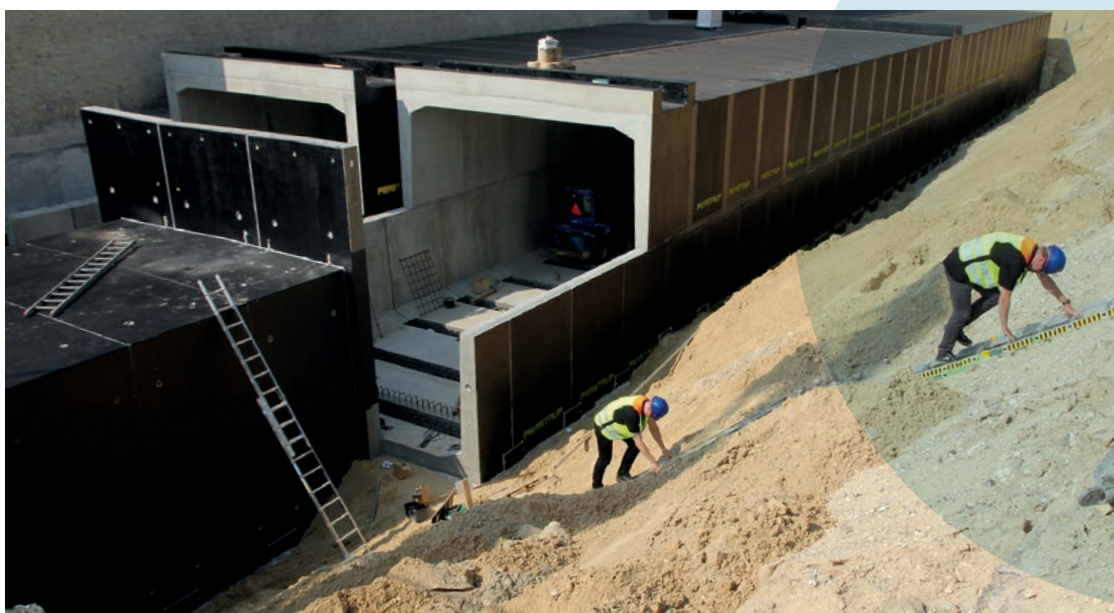
Frederiksberg Forsyning har etableret en lagertank til Fjernkøling i Carlsberg Byen. Til venstre: Carlsberg Byen.
